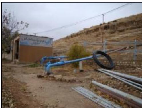
شکل ۳- ایستگاه پمپاژ سراب‌کلان و موقعیت چاه شماره یک و دو (چاه شماره یک نزدیک‌تر به ساختمان ایستگاه)
